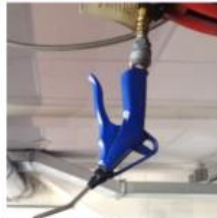
Leckagen sorgen für Druckluftbedarf
