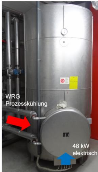
48 kW Boiler mit WRG Prozesskühlung
