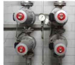
Kühlpumpen UG laufen dauernd und Pumpen Kühlwasser in die Attika
