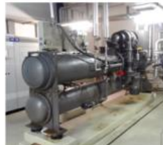
Kältemaschinen produzieren Kälte zum Abführen der Wärme
