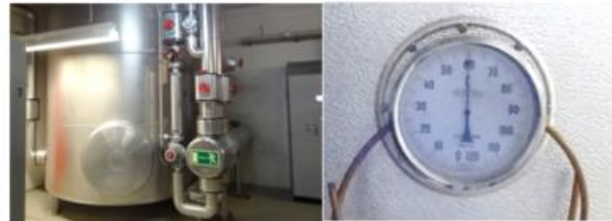
Überangebot Abwärme Druckluftkühlung Klimazentral Attika FE 80
