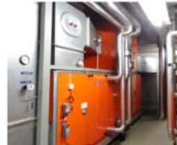
Die Lüftung führt die Wärme mit kalter Luft ab
