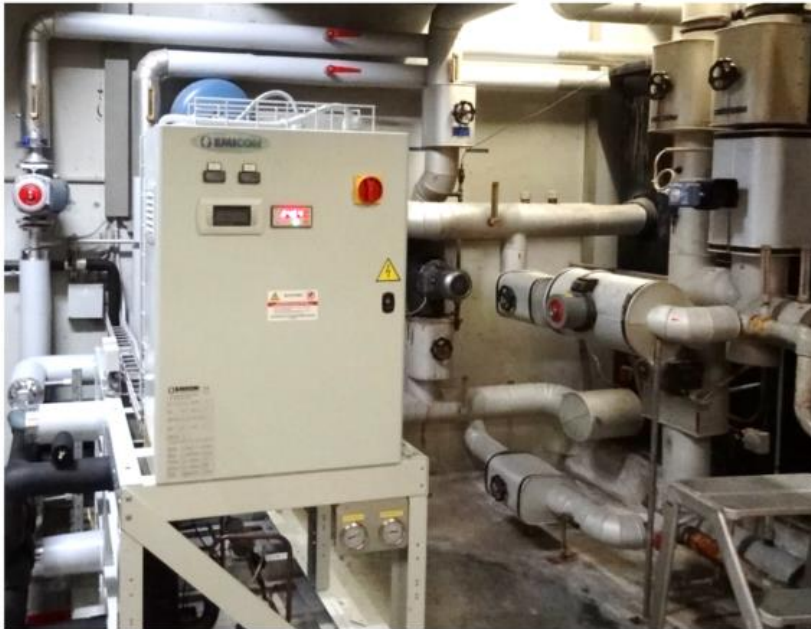
Prozesskühlung mit WRG Abwärme an Lüftung UG und Warmwasser Boiler
