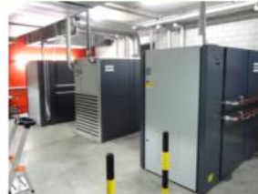
Kompressoren laufen dauernd
