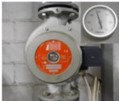
Fernleitungspumpen verteilen Wärme im ganzen Areal
